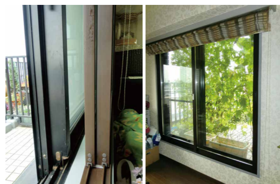
●内装をいじることなく既存木製枠を利用して取り付けられた内窓。
